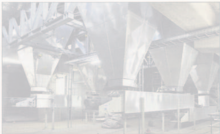
Seit 8. März ist die moderne Schlauchfilteranlage im Einsatz, die die Staubemission noch weiter reduziert.
